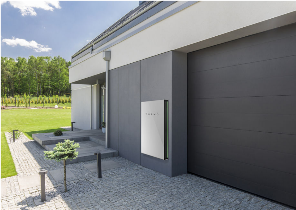
Figura 2. Ejemplo de un Powerwall instalado en una casa
